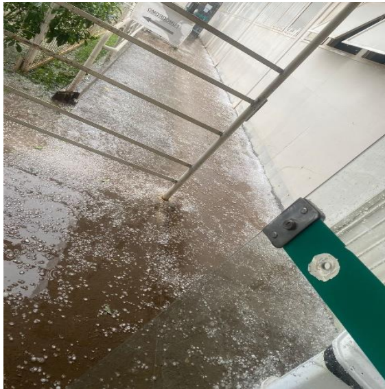
Figura 1 – Danos ocorridos pela chuva no dia 08/11/2022
