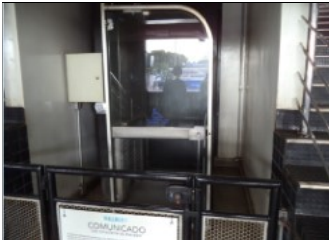
Elevador em perfeito estado de funcionamento
