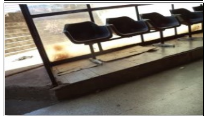
Vidraça suja, área destinada a taxistas
