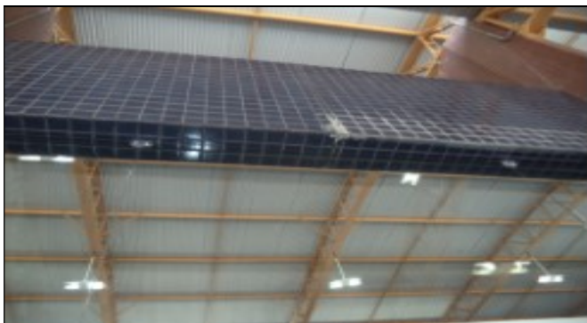
Trinca detectada na estrutura da edificação
