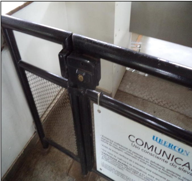
Acesso ao elevador objeto da notificação p/reparo
