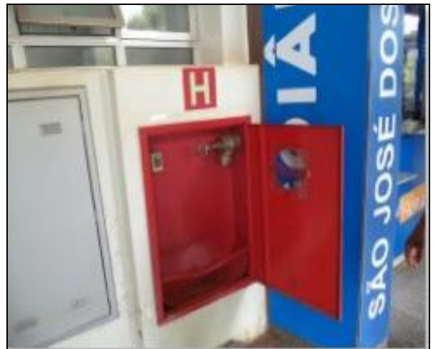
Saguão primeiro piso sem manguieras hid. Uberaba, 29 de fevereiro de 2024
