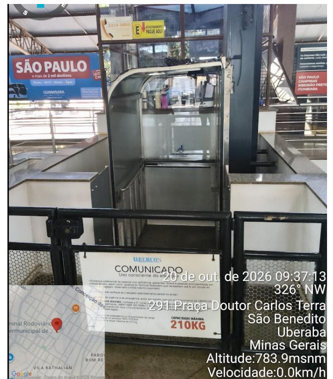
Elevador funcionando e com placa sinalização
