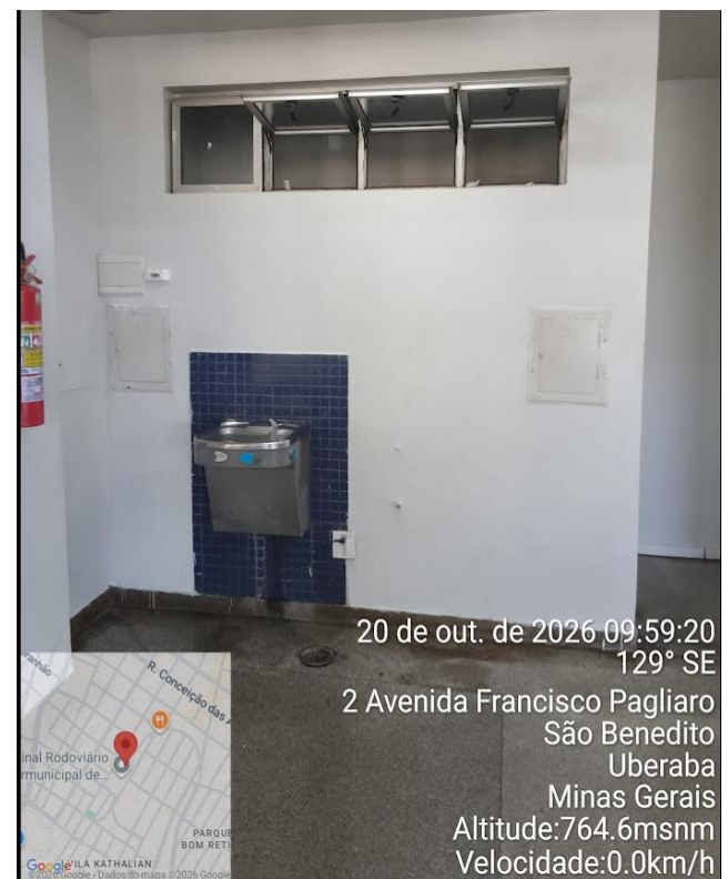
Pintura solicitada em fiscalização anterior
