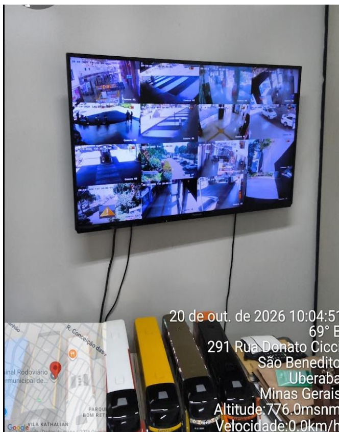
Sistema de monitoramento, funcionando
